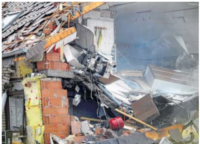
Völlige Zerstörung: Ein Ofen aus dem Badezimmer im ersten Stock ragt aus dem einsturzgefährdeten Gebäude heraus.
