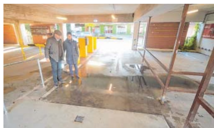
Falsch platziert und zu klein: Der Abfluss wurde auf der Rampe angelegt statt davor. Dadurch bildet sich bei Regen am Fuß der Rampe eine große Pfütze, die Parkhausnutzer umgehen müssen. FOTO: MEYER
